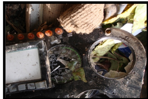
Fotografía No. 16 Vista de Daños del Panel Principal
