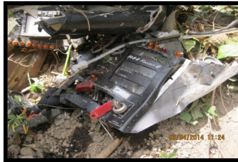
Fotografía No. 17 Vista de Daños al Panel Eléctrico
